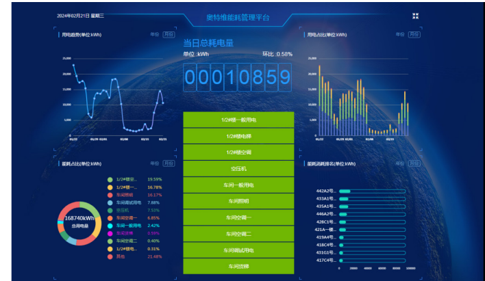
能源监控管理系统
